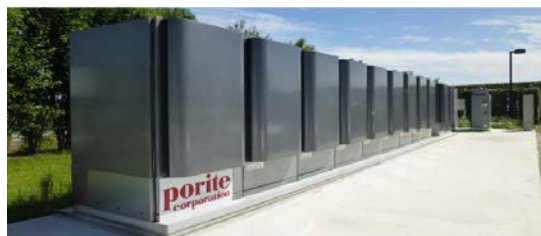
250kW SOFCシステム（熊谷第二工場設置）
