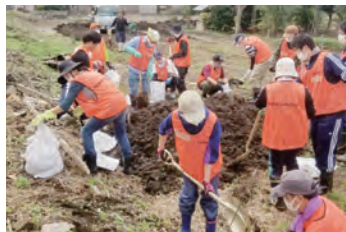
台風19号の被害復旧活動
